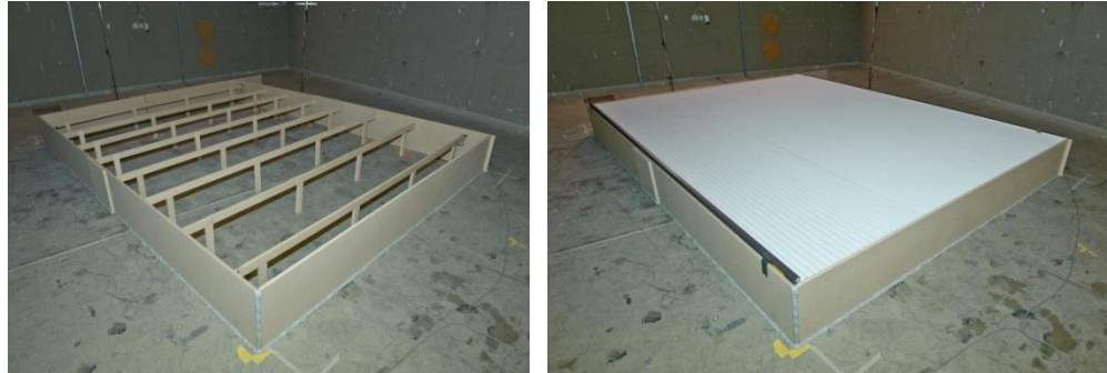
Bild 7: Einbau der Anlage über Hallraumboden aufgeständert mit umlaufend geschlossenem Rand.
